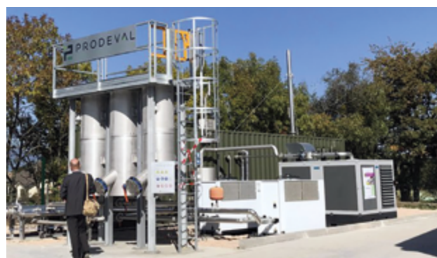
Unité d'épuration du biogaz brut prétraité
