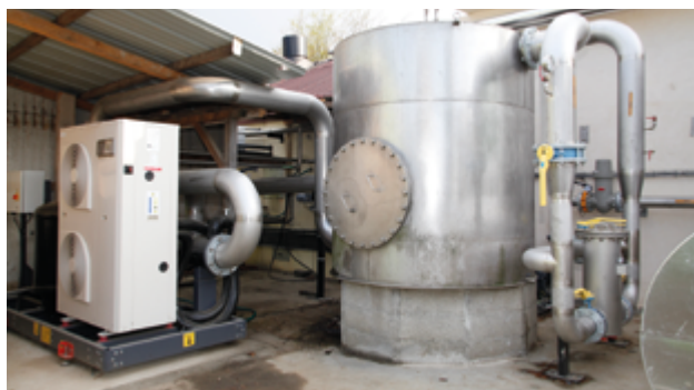
Unité de prétraitement du biogaz brut
