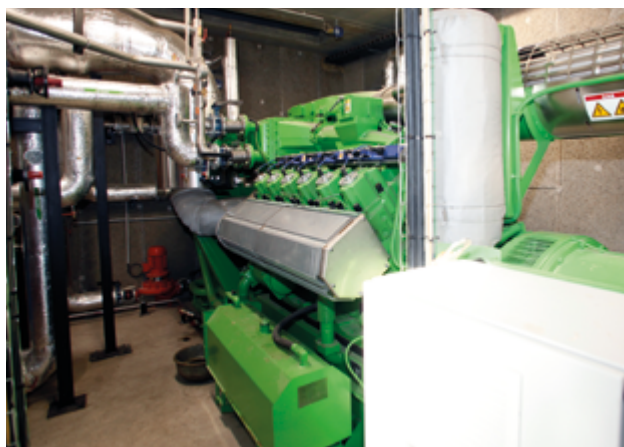
Unité de cogénération du biogaz brut prétraité
