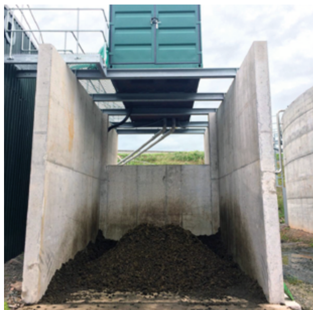
Séparation de phase de digestat brut
